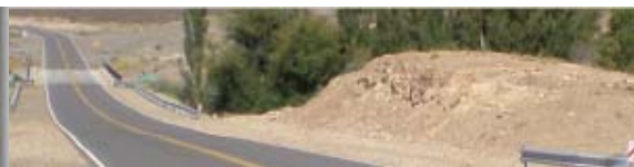
Barandas/barreras cortas y sin transición
